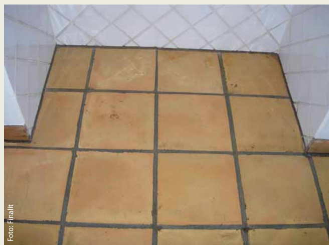
Cotto nach der Reinigung und dem Einsatz der atmungsaktiven „Finalit Heiß-Imprägnierung“ als langfristiger Schutz.
