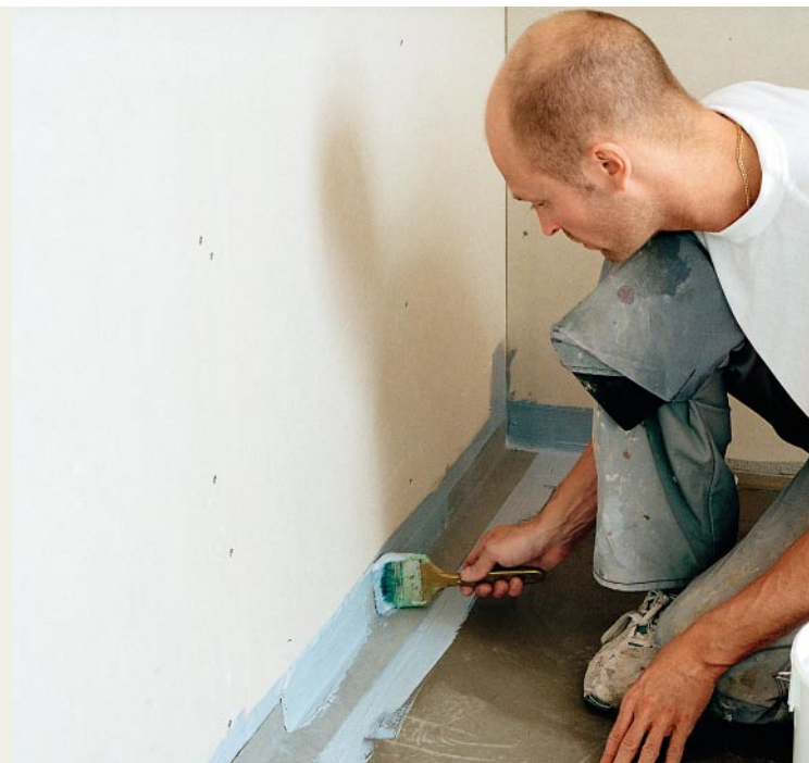
Das Band ist so weit wie möglich in die Ecke zu führen und zwar so, dass gerade keine Schlaufe entsteht. Deshalb ist es wichtig, dass das Dichtband ausreichend querelastisch ist und die notwendige Dehnung zulässt.
