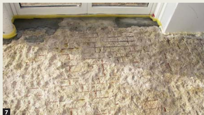
7 Diesen maroden Untergrund kann keine Spachtelmasse „heilen“.
